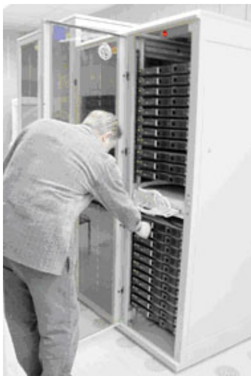
Фото 69. Стойки с вычислителями
